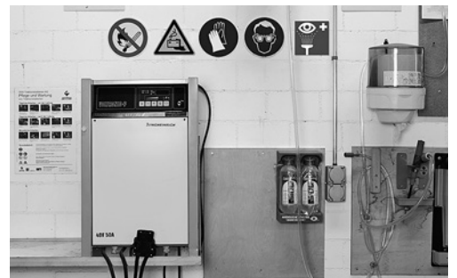
5 Vorschriftsgemäss ausgerüstete Batterieladestation mit Rauchverbot. Schutzbrille und Augendusche sind vorhanden.
